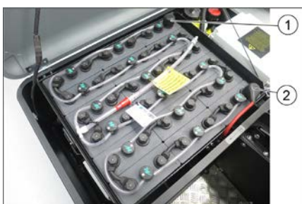
Batteriepole - in Fahrtrichtung links
